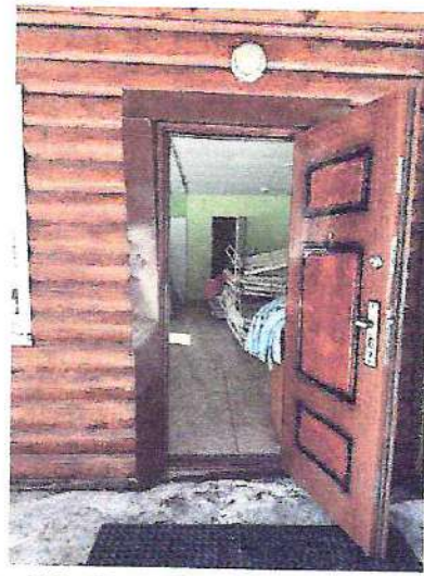
фото №2 «Дверь (завышенные пороги)»
