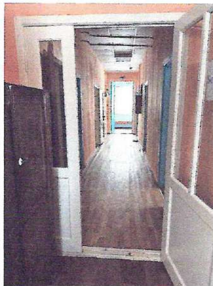
фото № 4 «Дверные проемы с завышенными порогами»
